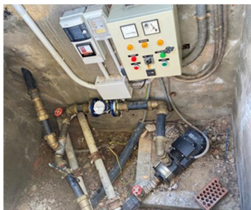
Cuadro Reelevadora depósito Viejo
